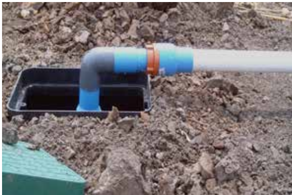
Caja de válvulas para hidrante
